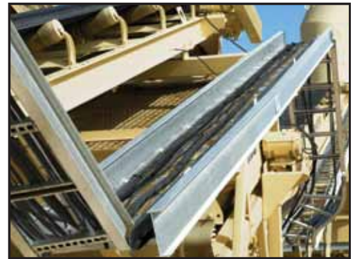
Las bandejas de cables evitan que los cables de alimentación y control toquen el suelo.
