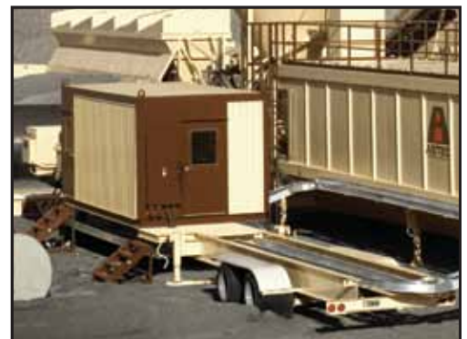
El tablero de alimentación principal de ubicación central y la caja de empalmes mantienen cortos los tramos de cables.
